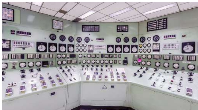
Рис. 1. Типовий блочний щит керування електростанції
